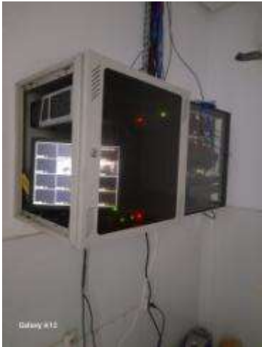
EQUIPAMENTO DE TI
