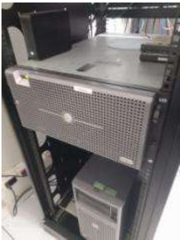
EQUIPAMENTO DE TI
