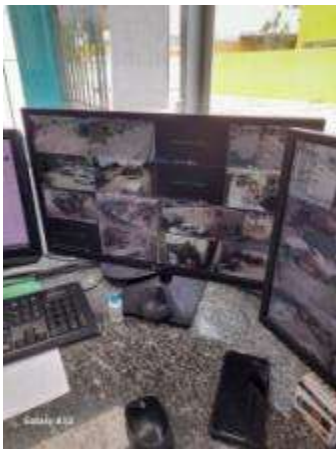
EQUIPAMENTO DE TI
