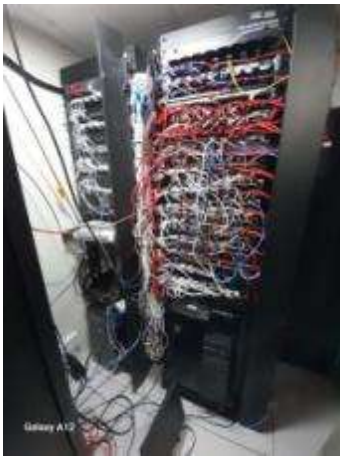
EQUIPAMENTO DE TI
