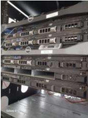
EQUIPAMENTO DE TI
