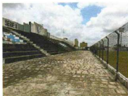
Foto 07- Arquibancada sem marquise
