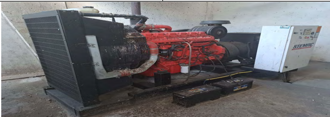
Foto 03: Vista do gerador do clube
