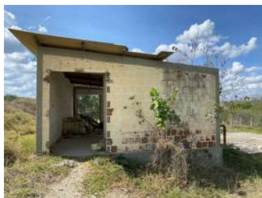
Casa de bombas
