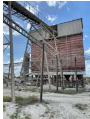
Silos de cru
