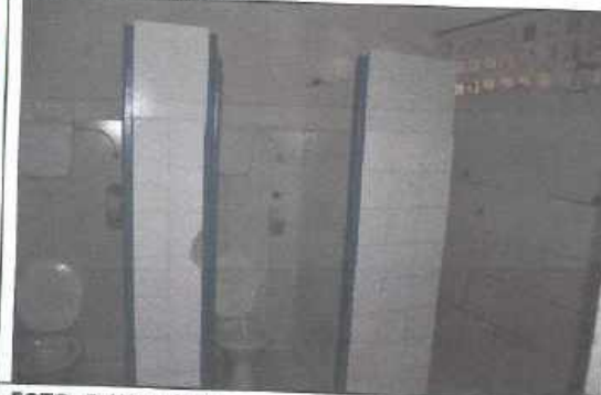
FOTO -6: Wc galpão
