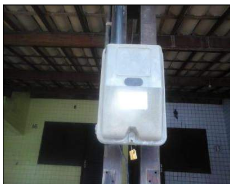
Contador de energia
