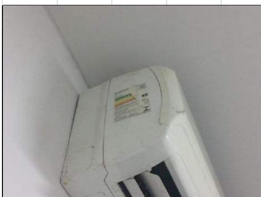
Condicionador de Ar
