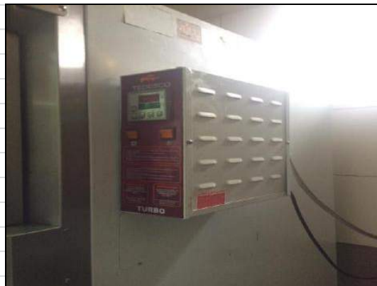
Vista Lateral do Forno
