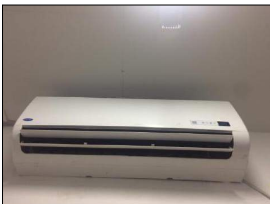
Condicionador de Ar
