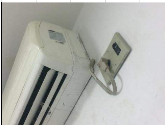
Condicionador de Ar
