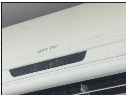
Condicionador de Ar
