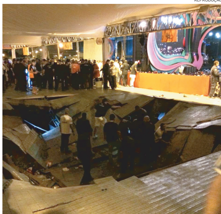
Um buraco se abriu na estrutura e 60 pessoas caíram; 26 ficaram feridas
