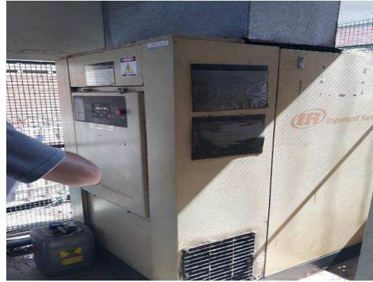
Compressor parafuso Ingersol
