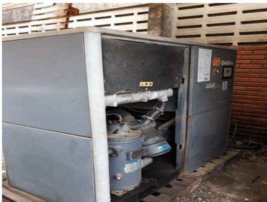
Compressor de ar Atlas
