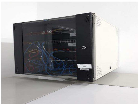
Rack de Rede
