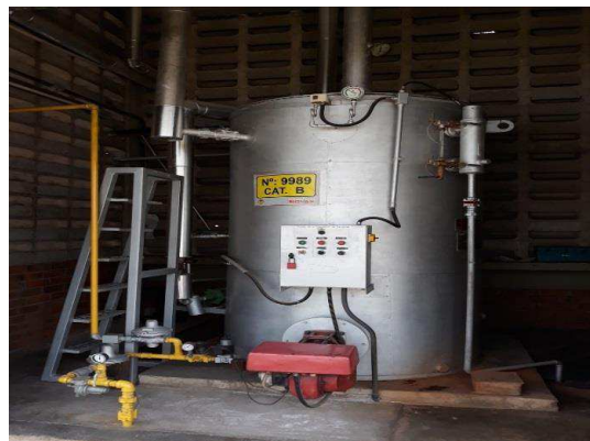
Caldeira Ata Combustão
